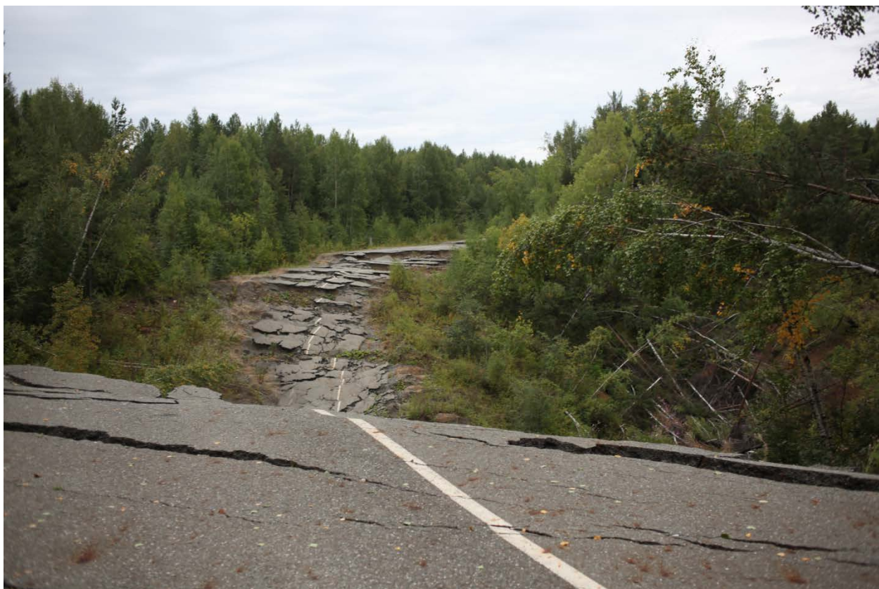
Штреки железодобывающей шахты Песчанской (Краснотурьинск) привели к разрушению дороги.
